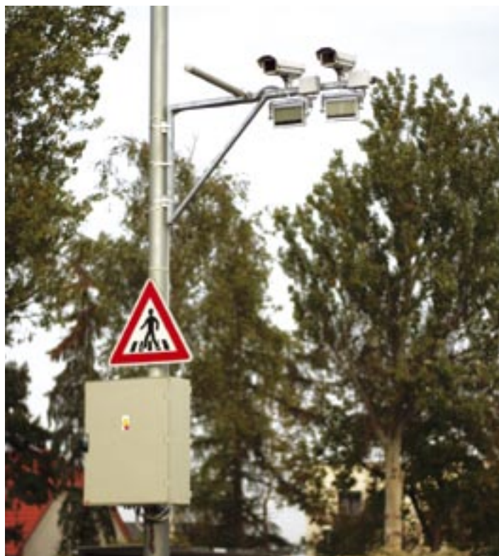
Instalace UnicomVELOCITY na sloupu VO
